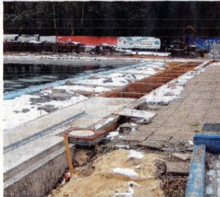
Am Beckenrand im Wiesentalbad muss ein Teil der Fundamente (hinten) wegen der Witterung auf den Beton noch warten. FOTO: C. MEISTER
